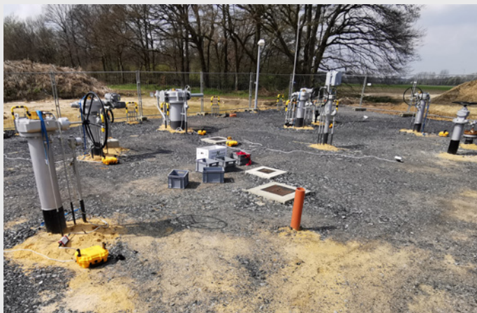
Bild 6: Station Marbeck, Installation der Messsensoren
