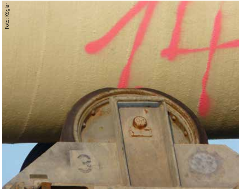
Bild 5: Überlastete Rolle während des Auflegens einer Rohrleitung DN 1000 im Oberbogen
