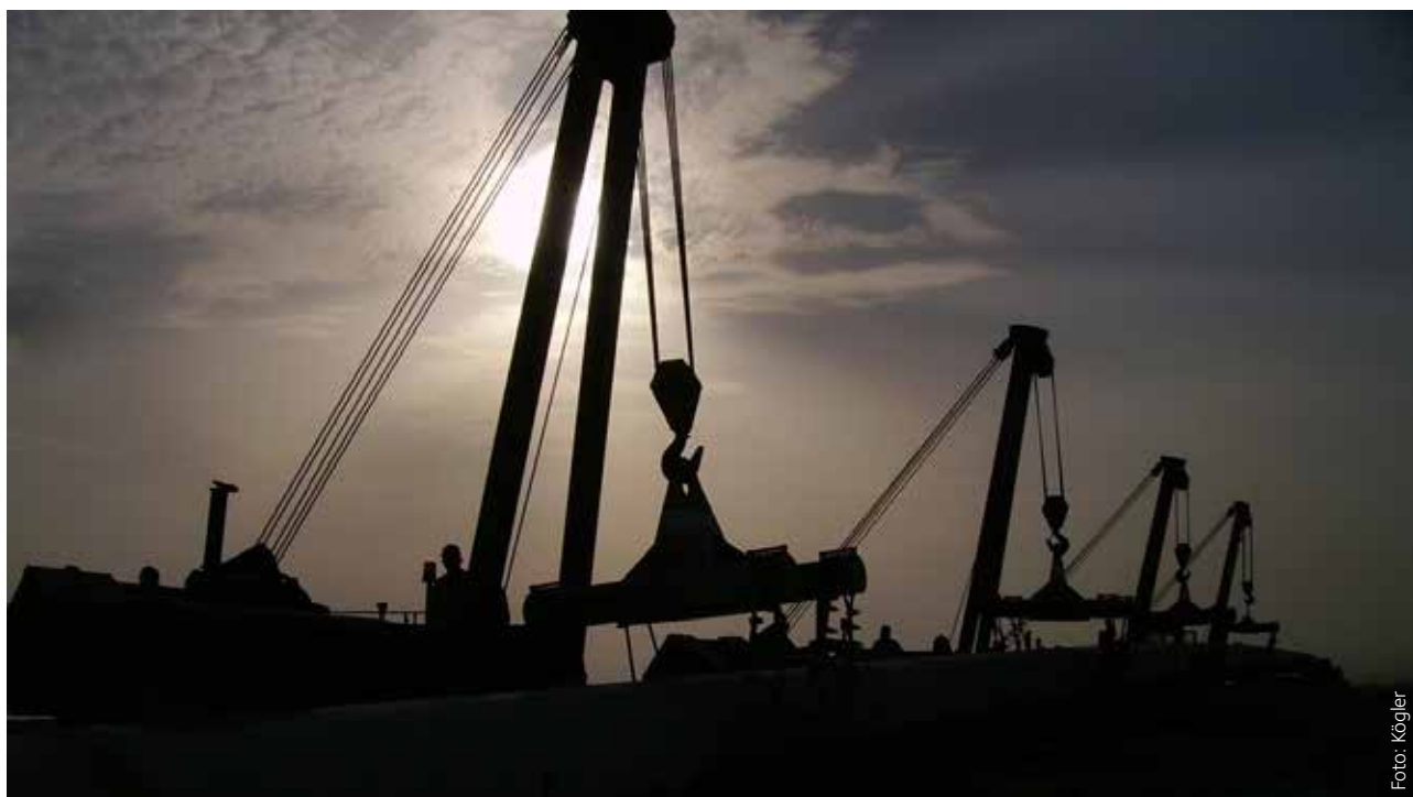
Bild 6: Unzureichende Beleuchtung eines Oberbogens DN 1200 Foto: Kögler
